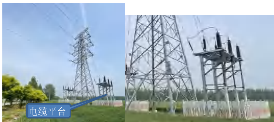
图 2.1-4 铁塔及电缆平台图
